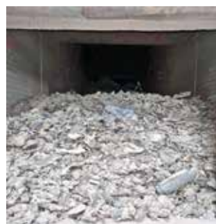
炉内に堆積した不燃物
