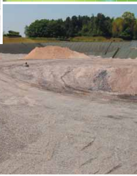
楽善埋立処分場
