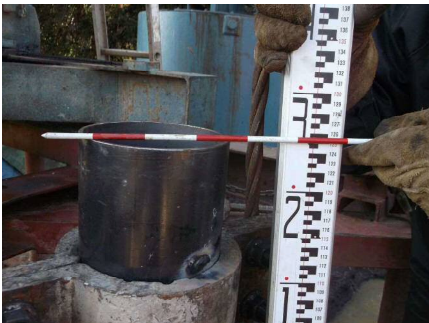
150Aケーシング管挿入 挿入完了 全長=132.00m 残尺= 1.25m 挿入深度=130.75m
