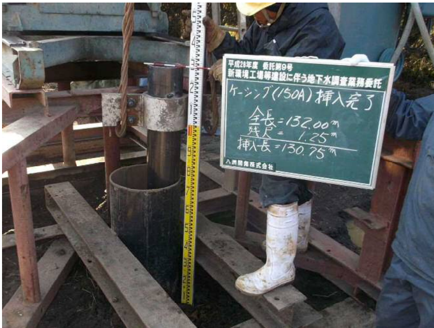
150Aケーシング管挿入 挿入完了 全長=132.00m 残尺= 1.25m 挿入深度=130.75m
