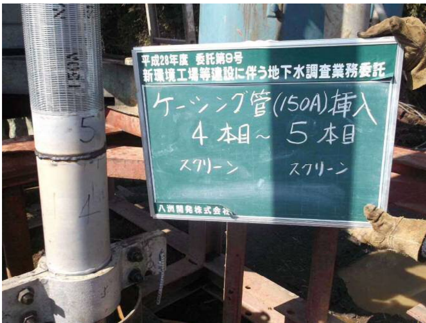
150Aケーシング管挿入 4本目～5本目 (スクリーン) (スクリーン)
