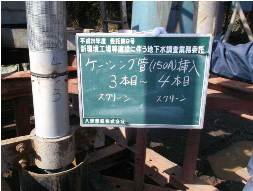
150Aケーシング管挿入 3本目～4本目 (スクリーン) (スクリーン)
