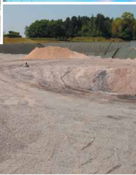
楽善埋立処分場
