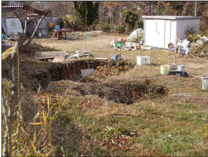
写真 6-1 地表の陥没状況
