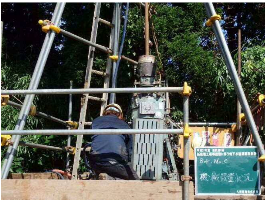
No. C 機械設置状況
