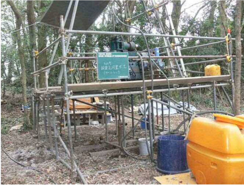
No. 5 (セメントミルク) 調査孔閉塞状況
